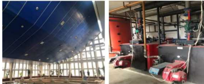
Fig. 1. Situația curentă a instalațiilor de la complexul Rekreativ
